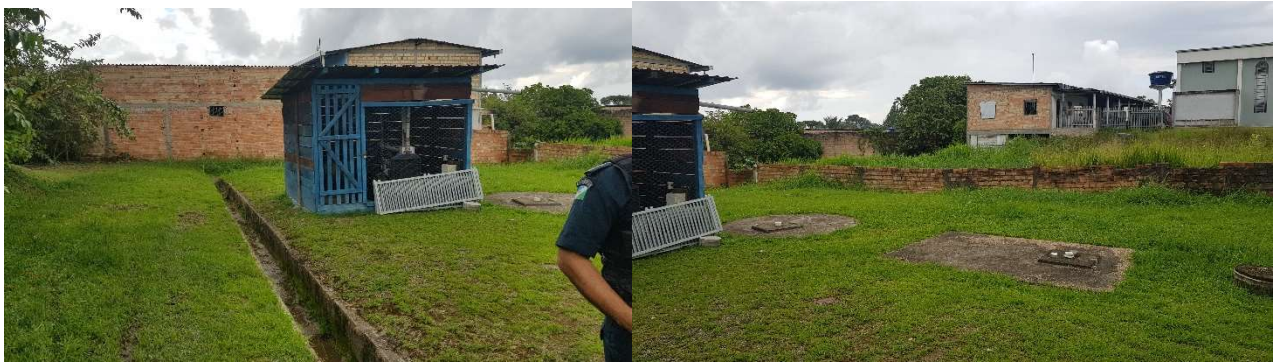
Figura 09 – A casa para abrigo do grupo gerador (em madeira) com a vaga de drenagem de águas pluviais. A grela adicional encontra-se no local, faltando a instalação a locação da fossa e sumidouro, por estar localizada no centro do terreno, permite a criação de 3 vagas para veículos em área privativa na instituição.
